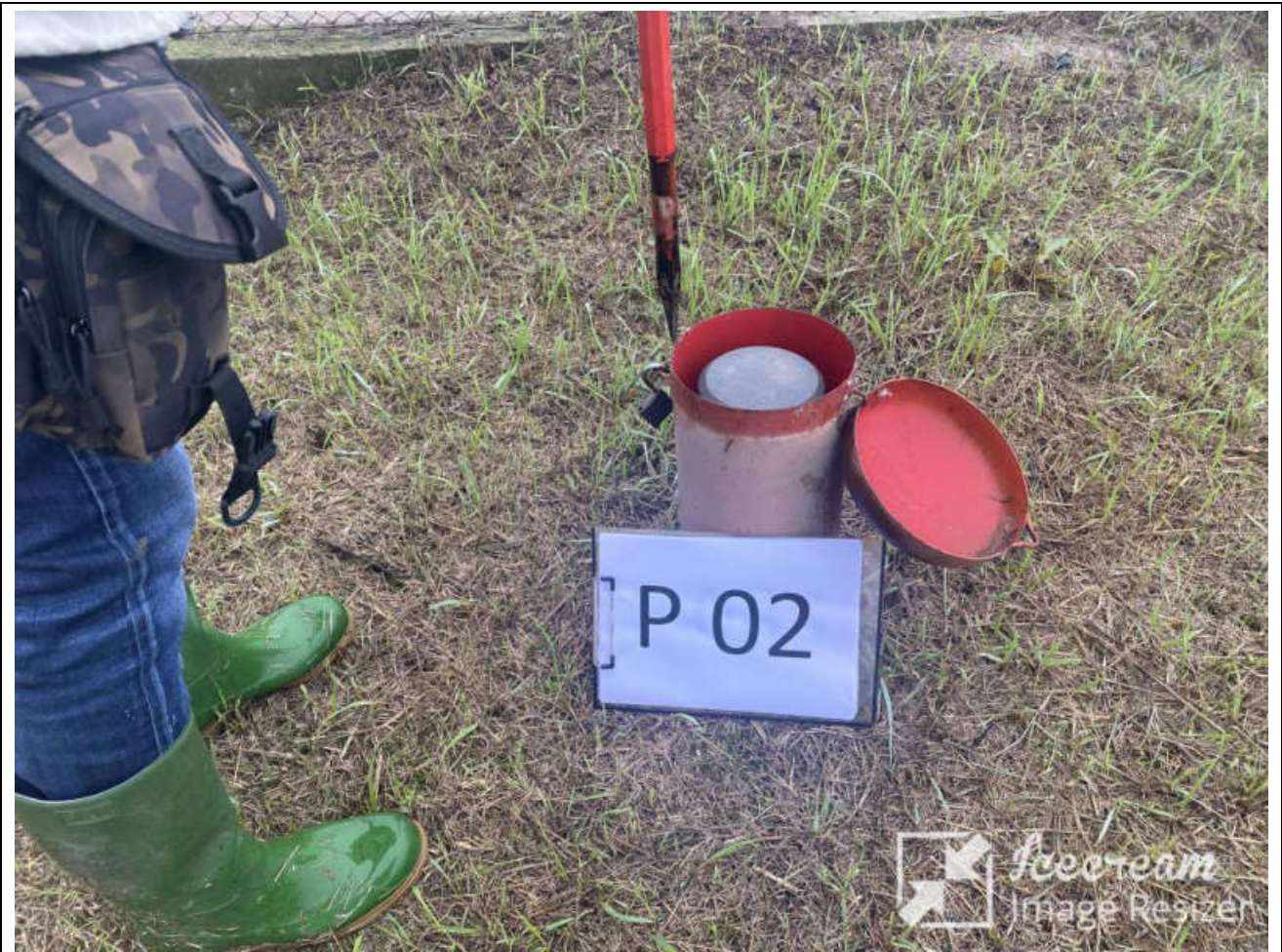
Fotografia Piezometro P 02.
