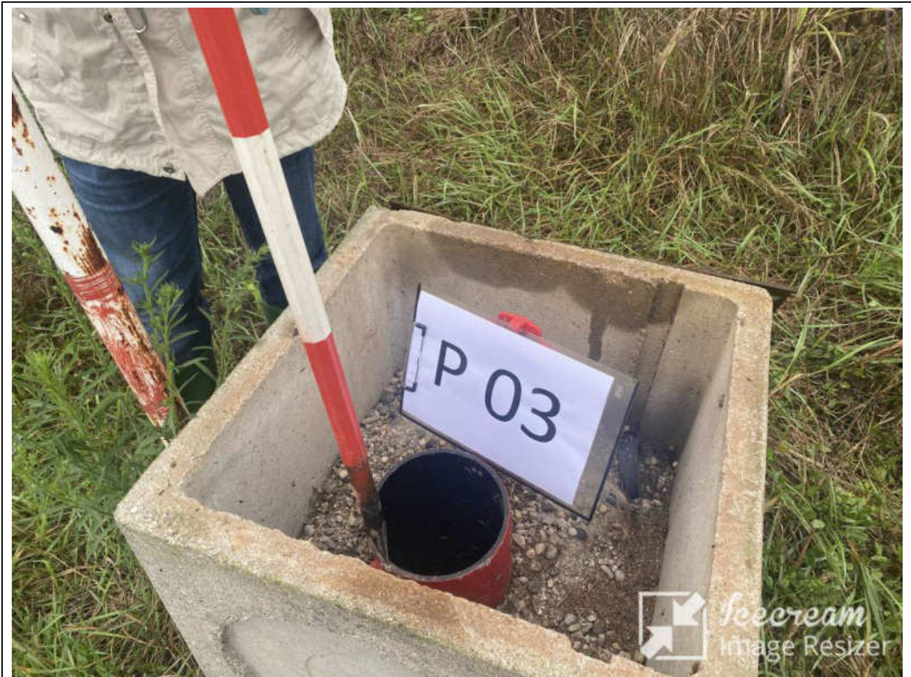
Fotografia Piezometro P 03.
